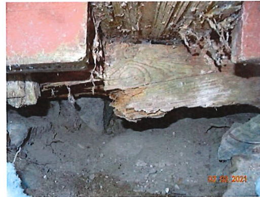
Bild 4: Rötskador i syll och bjälklag
