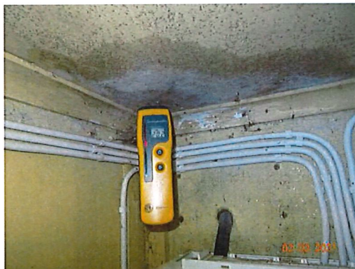
Bild 5: Pågående fuktskada i tak och vägg intill elcentral
