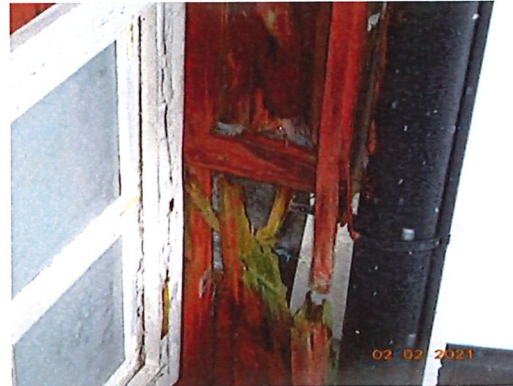
Bild 2: Omfattande rötskada i tak, höger om entré
