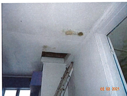
Bild 15: Fuktbläck och mögelpåväxt, tak i övre hall
