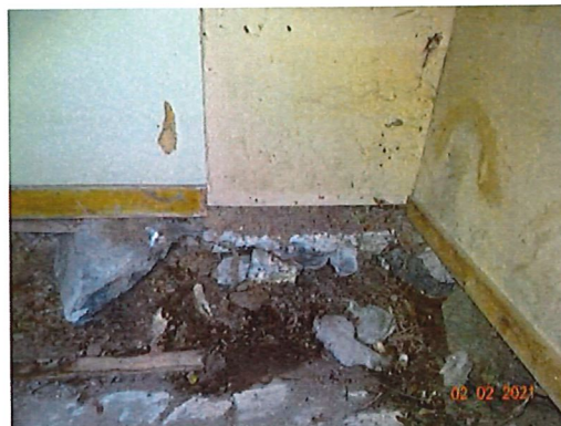
Bild 8: marken inne i huset är fuktig
