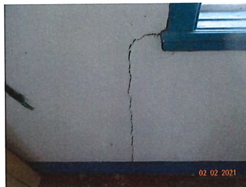
Bild 14: Sprickor förekommer, tyder på rörelser i konstruktionen
