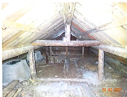
Bild 16: Gammal vind, missfärgningar och tecken på insektsangrepp förekommer
