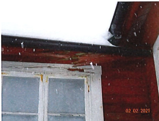
Bild 3: Rötskada även i vägg och fönster
