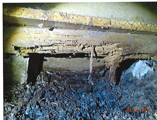
Bild 10: Rötskador i bjälklag
