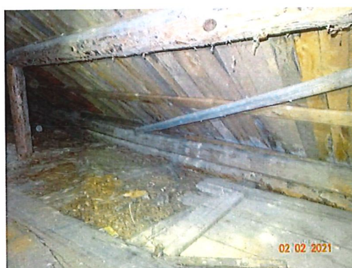
Bild 17: liggande stockar i stommen lutar, uppkilad underlagstak noterades
